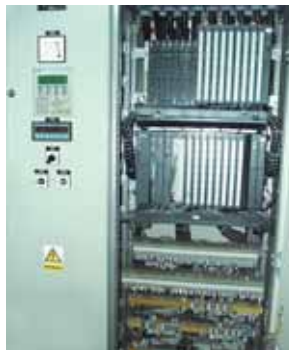
Rys.2. Sterownik S7-400 i panel operatorski OP-7 na koparce.
