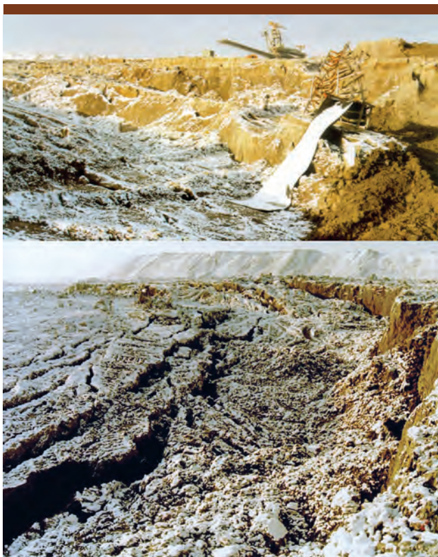
Fot. 3. Zerwa na poziomie roboczym Z-42 (poziom +415).
