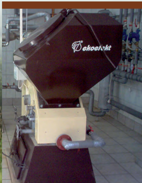
Kocioł na węgiel brunatny jest w pełni zautomatyzowany i ekologiczny
