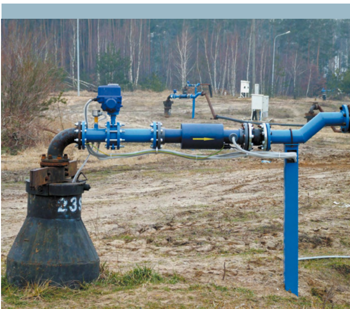
Automatyzacja pracy studni.
