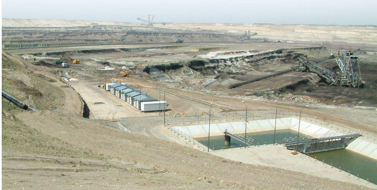
Pompownia z samonapływem.
