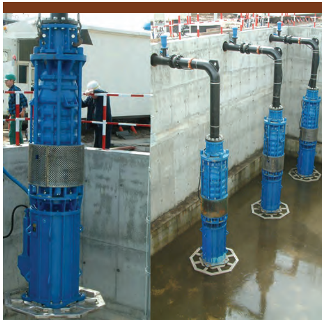
Rys. 24. Pompownia z pompami zatapialnymi OWZ-250A/4.
