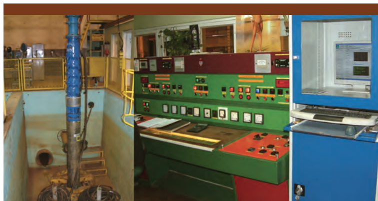
Rys. 3. Stacja prób głębinowych agregatów pompowych.
