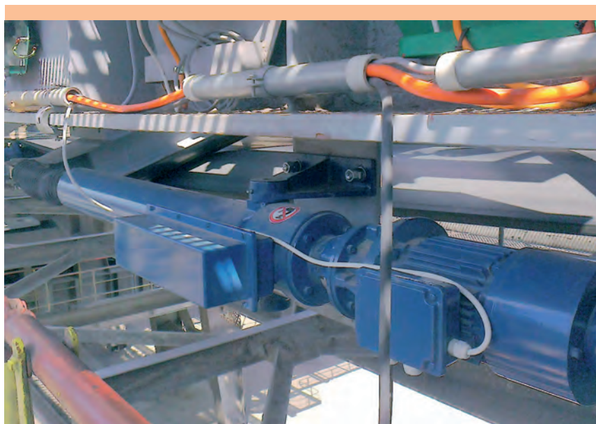
Widok układu na przenośniku G31 w Kopalni Bełchatów.
