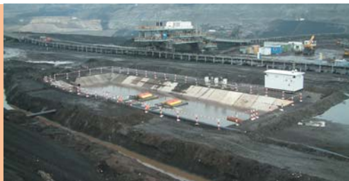
Fot. 16. Stanowisko pompowe w zbiorniku stałym Q_n=2 \times 500 \text{ m}^3/\text{h} , H_n=54 \text{ m} , element systemu odwadniania rowu II rzędu.
