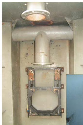
Fot. 11. Układ rurociągu ssącego i tłoczego w pontonie.
