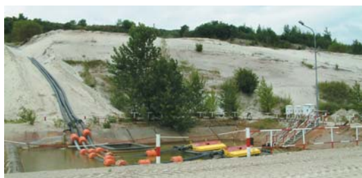
Fot. 14. Stanowisko pompowe w zbiorniku stałym Q_n=3 \times 500 \text{ m}^3/\text{h} , H_n=77 \text{ m} .
