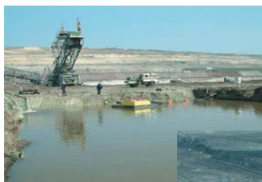
Fot. 18. Stanowisko pompowe w zbiorniku retencyjnym na poziomie nadkładowym.
