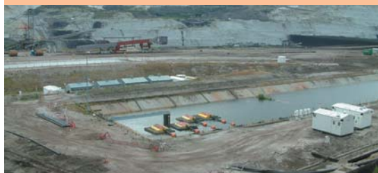
Fot. 17. Stanowisko pompowe w zbiorniku pompowni spągowej zwiększające potencjał pompowy pompowni Q_n=4 \times 500 \text{ m}^3/\text{h} , H_n=77 \text{ m} .
