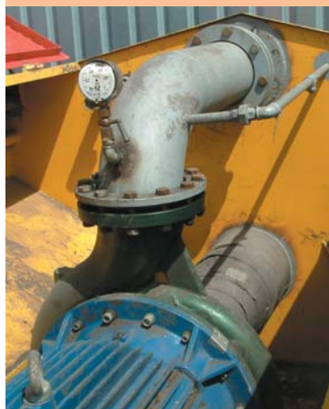
Fot. 9. Pompa monoblokowa typu ON-200FB/S w pontonie jak na fot. 8.
