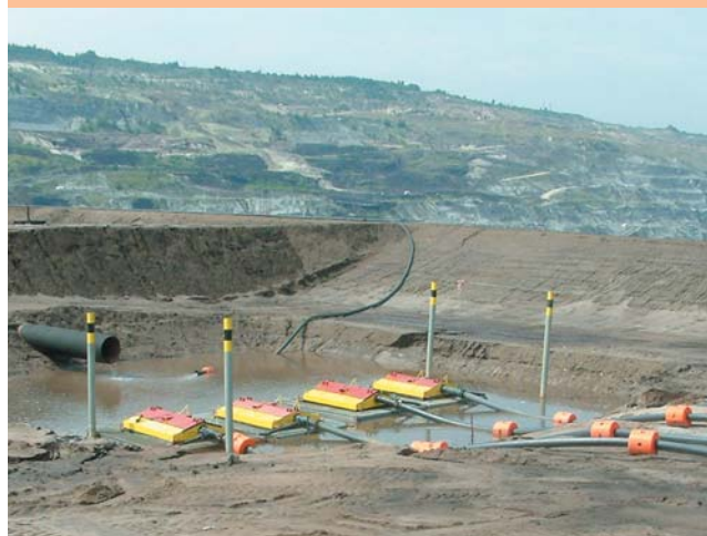
Fot. 21. Stanowisko pompowe w zbiorniku retencyjnym na zwałowisku wewnętrznym Q_n=4 \times 500 \text{ m}^3/\text{h} , H_n=77 \text{ m} .
