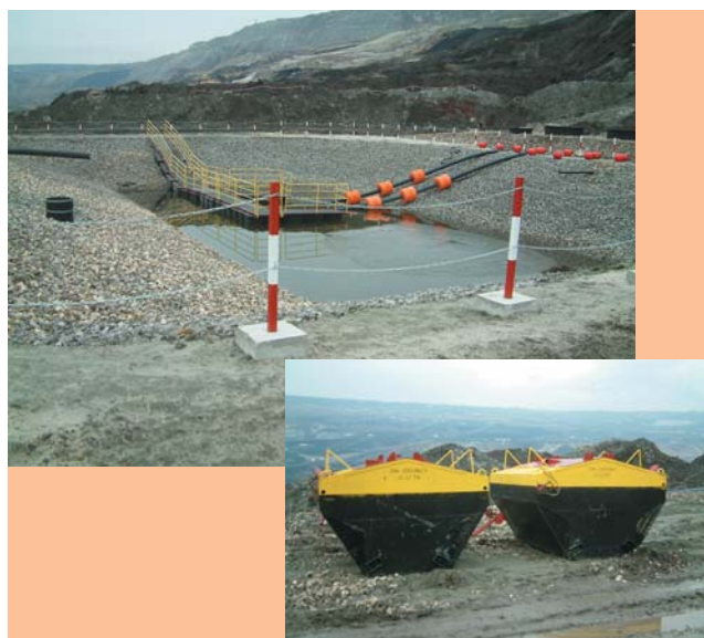
Fot. 23. Układy pompowe w I zbiorniku pompowni Q_n = 2 \times 500 \text{ m}^3/\text{h} , H_n = 38 \text{ m} .
