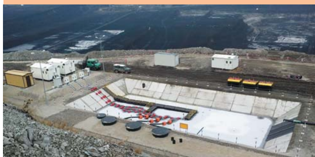
Fot. 24. Układy pompowe w II zbiorniku pompowni Q_n = 3 \times 500 \text{ m}^3/\text{h} , H_n = 77 \text{ m} .
