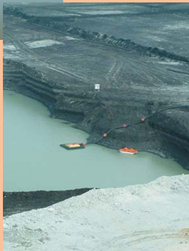
Fot. 19. Stanowisko pompowe w zbiorniku retencyjnym na poziomie węglowym.
