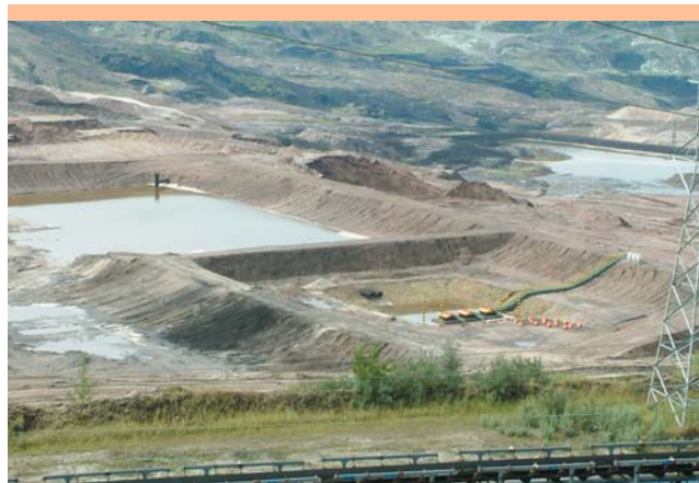
Fot. 20. Stanowisko pompowe w zbiorniku retencyjnym na zwałowisku wewnętrznym Q_n=3 \times 500 \text{ m}^3/\text{h} , H_n=54 \text{ m} .
